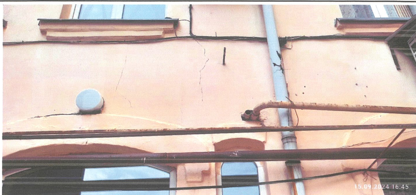
Рис. 5. Порушення штукатурного шару на стінах фасаду будівлі, дрібні вертикальні тріщини.
