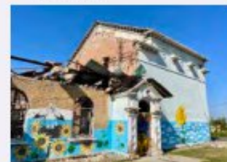
Рис. 32 Ірпінський Центральний будинок культури, що станом на початок 2023 року потребує відновлення
