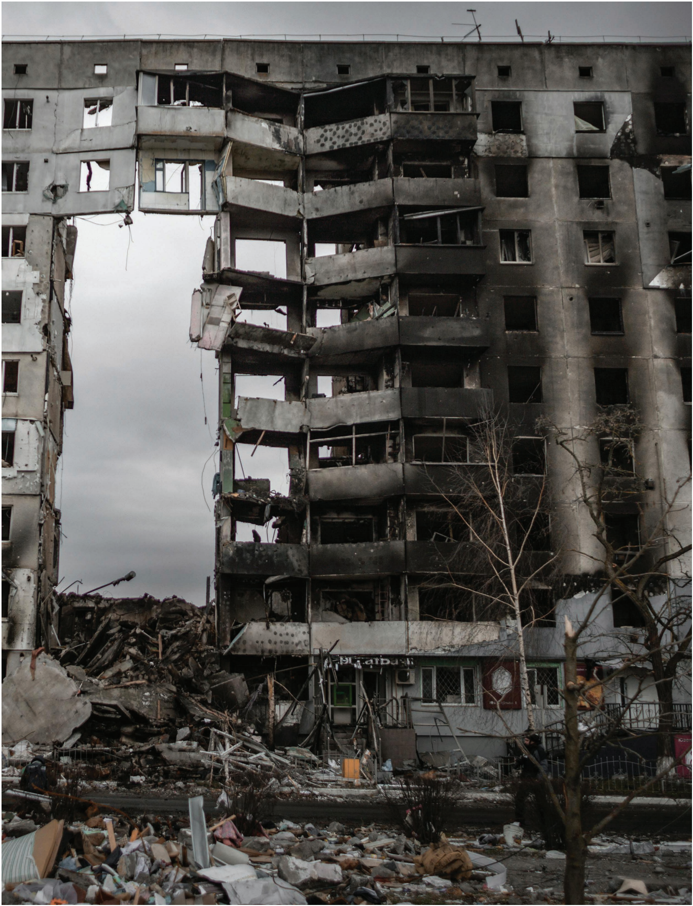
Рис.16 Зруйнований будинок в Бородянці, 6 квітня 2022 року Джерело: Pexels © Алесь Усцінаў
