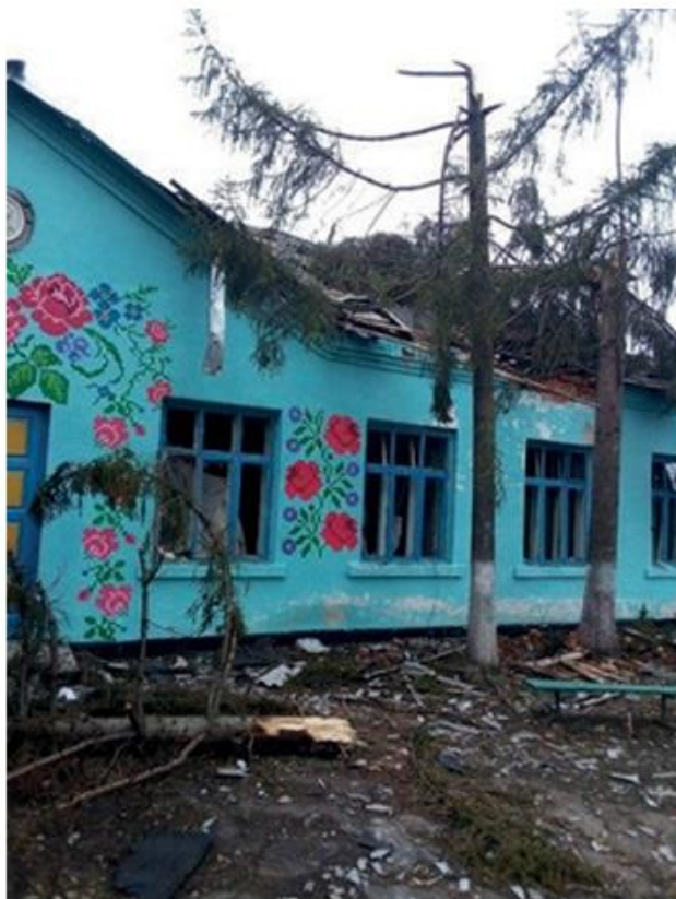
Фото 1. Зруйнована будівля Грабівського будинку фольклору
