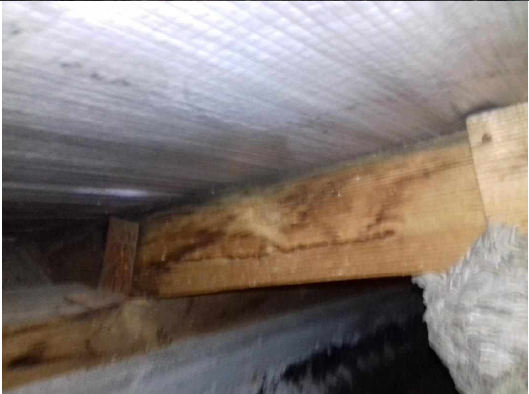
Рисунок А.6 (початок) - Сліди затікання крізь покрівельне покриття (листи типу «Ондулін») зафіксовані на усьому даху на підлогах горища, пароізоляційній плівці та на дерев'яних елементах каркасу.
