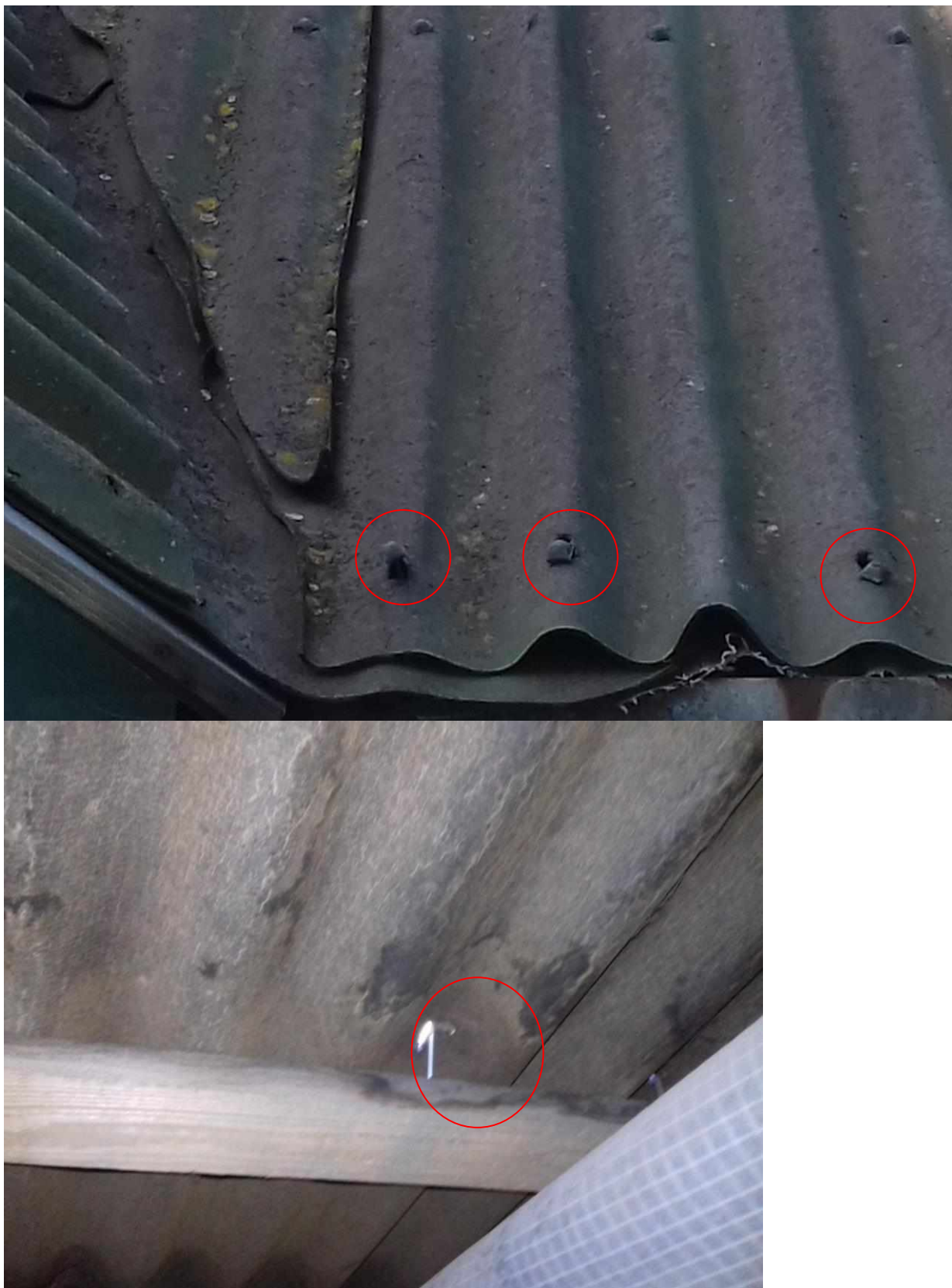
Рисунок А.2 - Місцеві руйнування покрівельних листів у вигляді значного збільшення отворів в місцях розташування кріпильних цвяхів, що робить місця кріплення листів негерметичними на цих ділянках.
