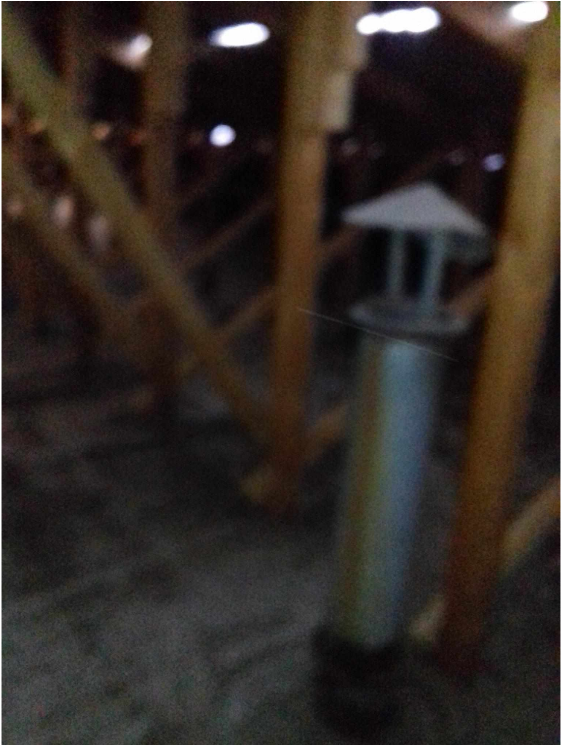
Рисунок А.13 (закінчення) - Усі випуски систем вентиляції приміщень та стояків системи каналізації (водовідведення) виведені у внутрішній простір горища, що допускає попадання вологого повітря у горищний простір і створює несприятливі умови для експлуатації несучих дерев'яних конструкцій даху та підвищене конденсаутворення на внутрішній поверхні пароізоляційної плівки під покрівельними листами.
