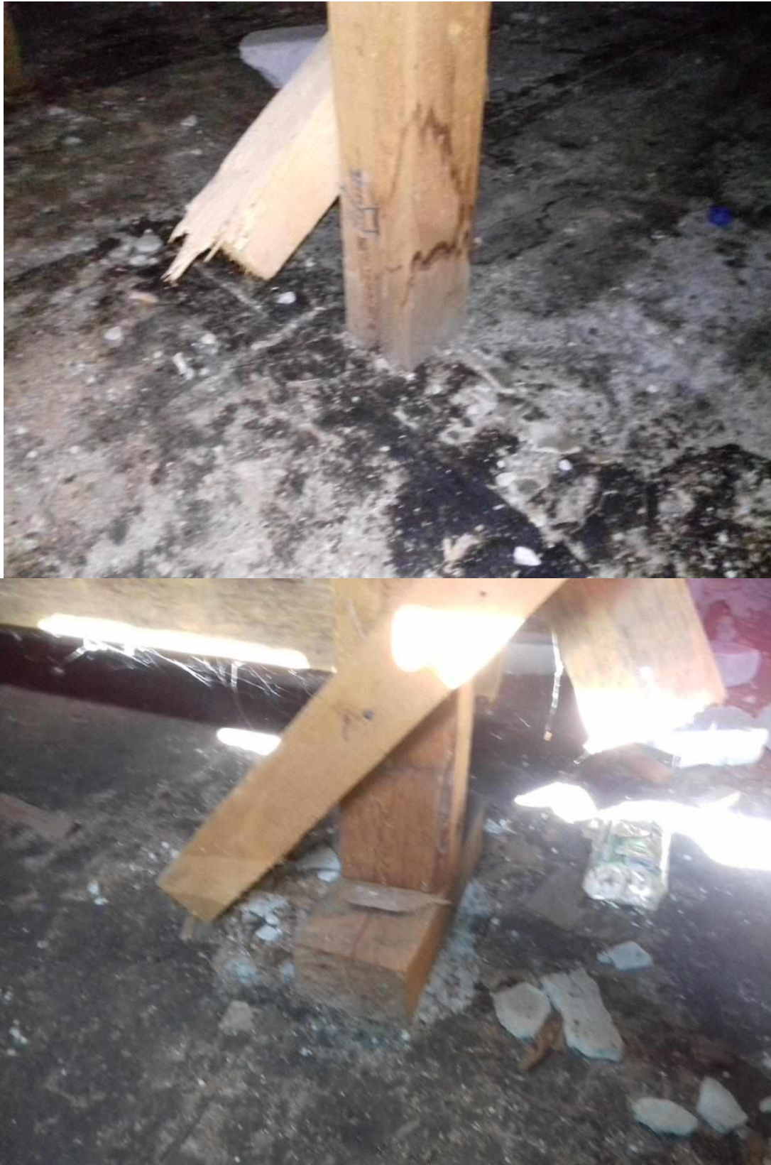
Рисунок А.7 (початок) - Дефекти, які були допущені при виконанні останньої реконструкції даху. Обпирання стійок каркасу безпосередньо на бітумну покрівлю (яка виконана раніше) чи на вирівнюючу набетонку раніше виконаного безгорищного даху, що не відповідає критерію жорсткості та стійкості каркасу при сприйнятті зовнішніх навантажень на нього.
