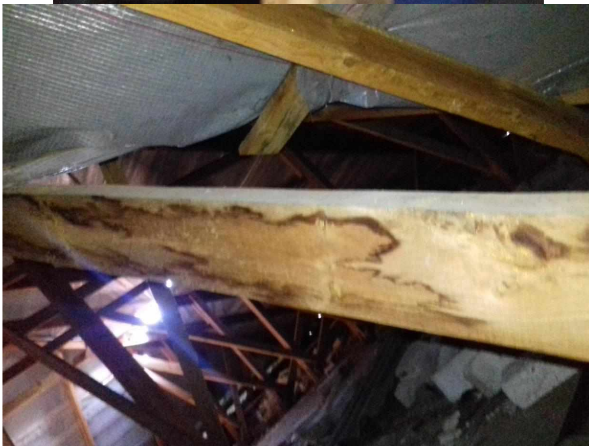
Рисунок А.6 (продовження) - Сліди затікання крізь покрівельне покриття (листи типу «Ондулін») зафіксовані на усьому даху на підлогах горища, пароізоляційній плівці та на дерев'яних елементах каркасу.
