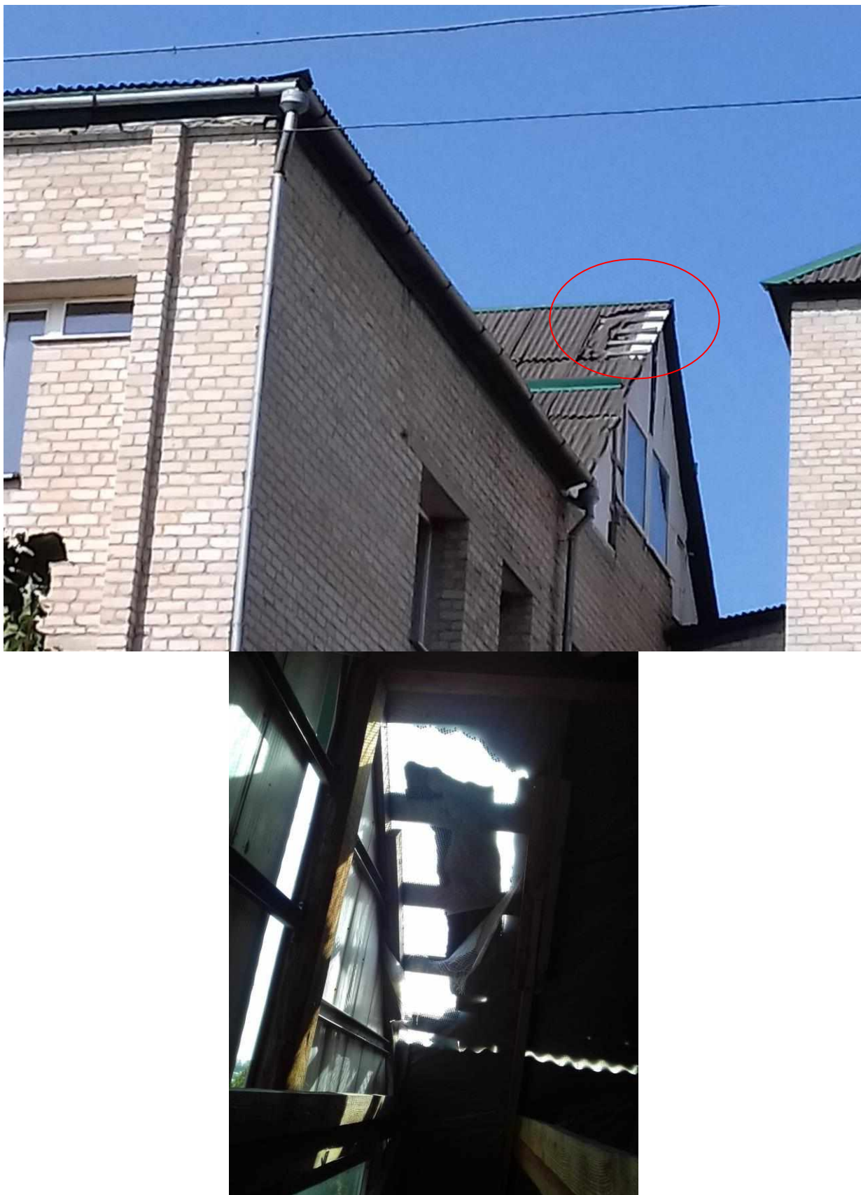
Рисунок А.3 - Відриви, відсутність окремих покрівельних листів на локальних ділянках. Ділянка покрівлі по ряду Е осі 5.
