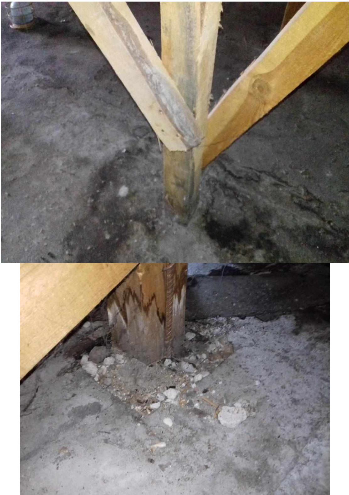
Рисунок А.7 (закінчення) - Дефекти, які були допущені при виконанні останньої реконструкції даху. Обпирання стійок каркасу безпосередньо на бітумну покрівлю (яка виконана раніше) чи на вирівнюючу набетонку раніше виконаного безгорищного даху, що не відповідає критерію жорсткості та стійкості каркасу при сприйнятті зовнішніх навантажень на нього.
