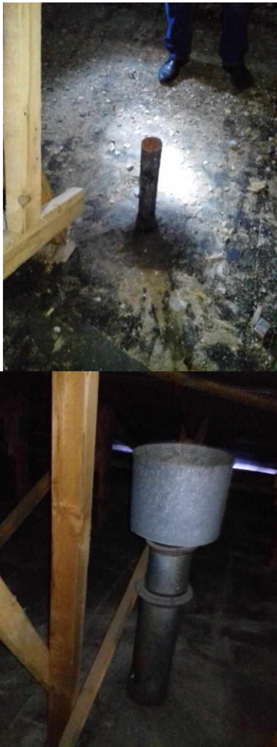
Рисунок А.13 (продовження) - Усі випуски систем вентиляції приміщень та стояків системи каналізації (водовідведення) виведені у внутрішній простір горища, що допускає попадання вологого повітря у горищний простір і створює несприятливі умови для експлуатації несучих дерев'яних конструкцій даху та підвищене конденсаутворення на внутрішній поверхні пароізоляційної плівки під покрівельними листами.
