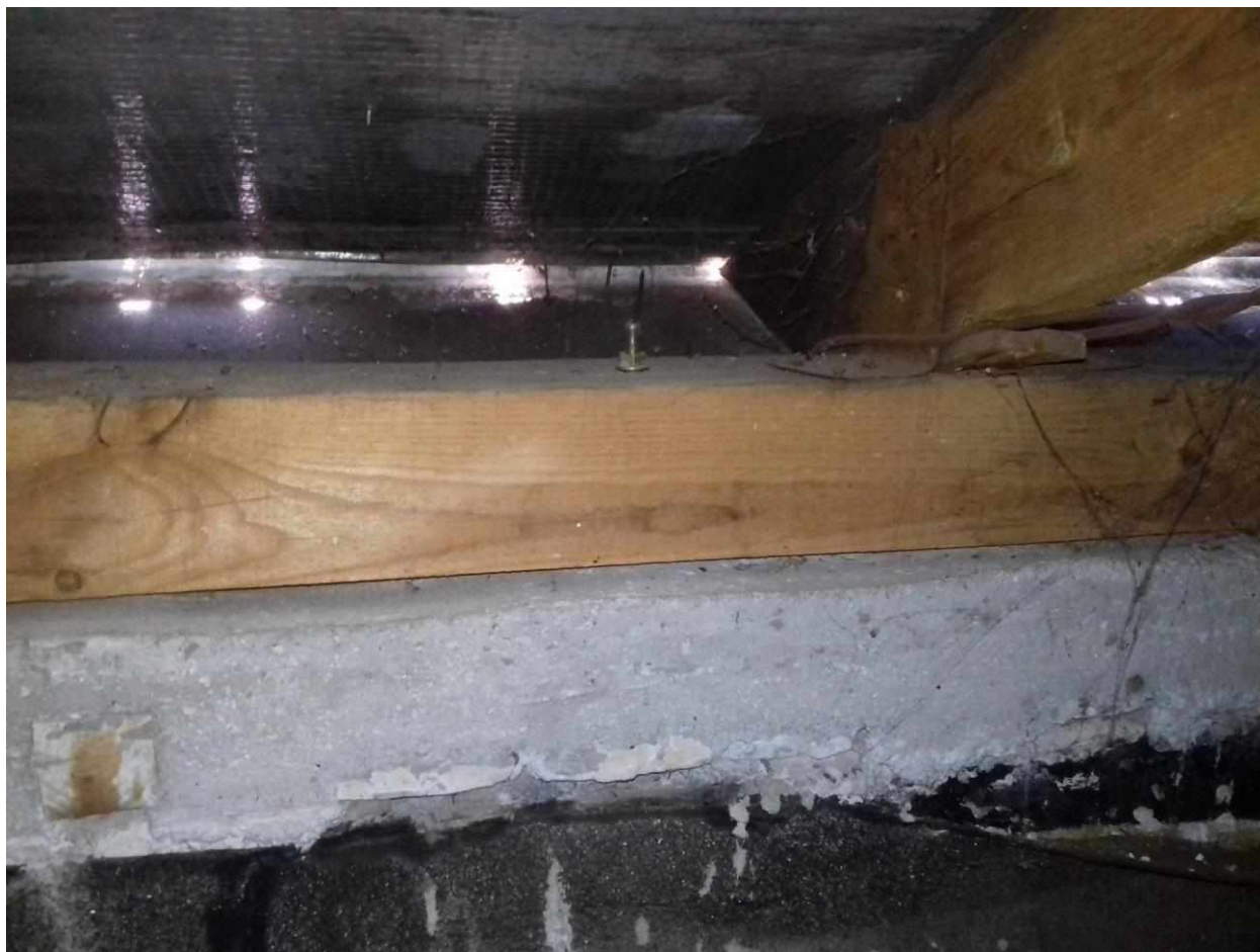
Рисунок А.10 - Відсутність гідроізоляційних шарів при контакті дерев'яних елементів (мауерлатні бруси) з цегляними (стіни) та залізобетонними (шов підсилення) елементами будівлі.
