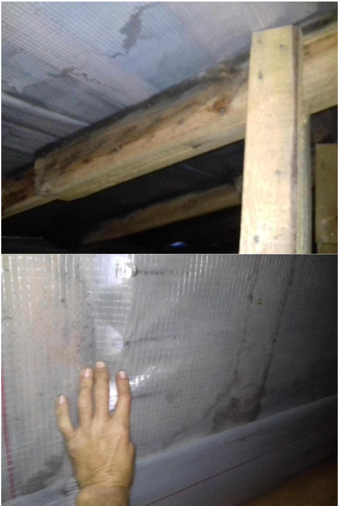
Рисунок А.6 (закінчення) - Сліди затікання крізь покрівельне покриття (листи типу «Ондулін») зафіксовані на усьому даху на підлогах горища, пароізоляційній плівці та на дерев`яних елементах каркасу.
