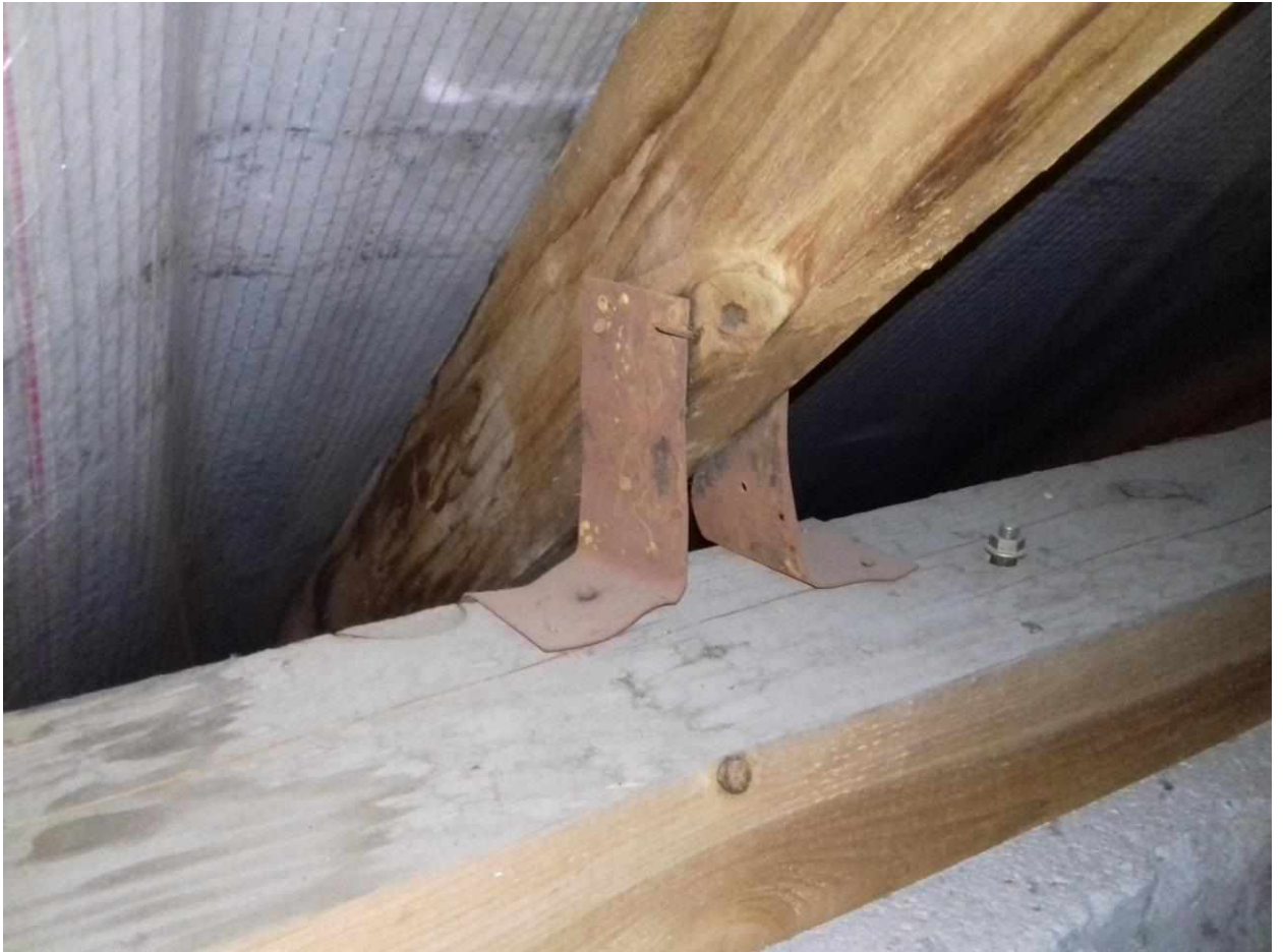
Рисунок А.12 (закінчення) - Кріплення крокв до мауерлатних брусів має низьку надійність, відсутні кріплення (дротяні скрутки) крокв до цегляних стін будівлі від можливості вітрового підриву даху.
