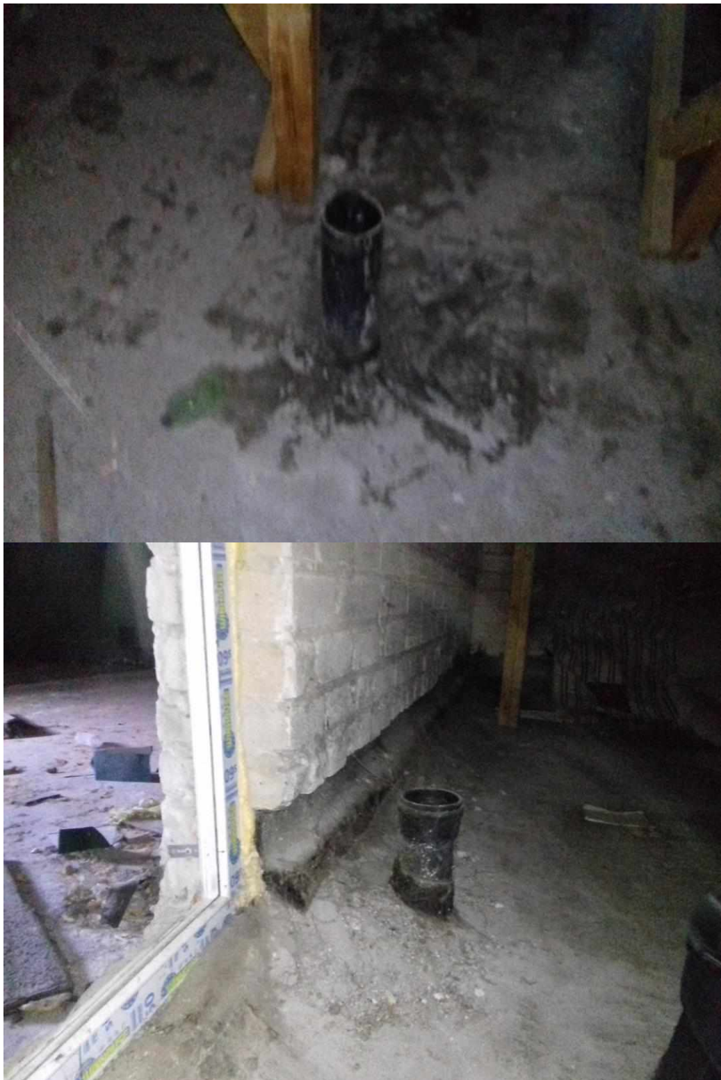
Рисунок А.13 (початок) - Усі випуски систем вентиляції приміщень та стояків системи каналізації (водовідведення) виведені у внутрішній простір горища, що допускає попадання вологого повітря у горищний простір і створює несприятливі умови для експлуатації несучих дерев'яних конструкцій даху та підвищене конденсаоутворення на внутрішній поверхні пароізоляційної плівки під покрівельними листами.
