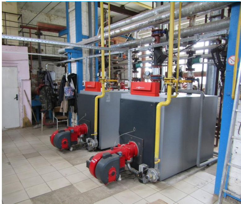
Фото джерела теплової енергії
