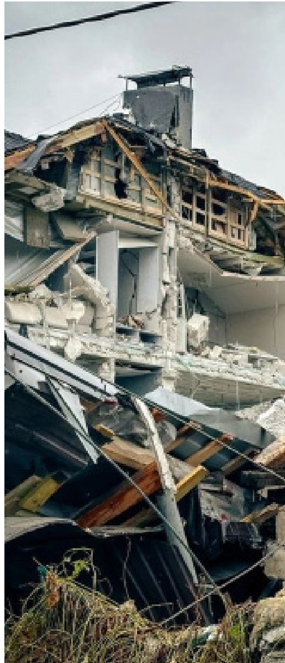
Рис. 11 Житловий будинок, зруйнований внаслідок ракетного обстрілу
