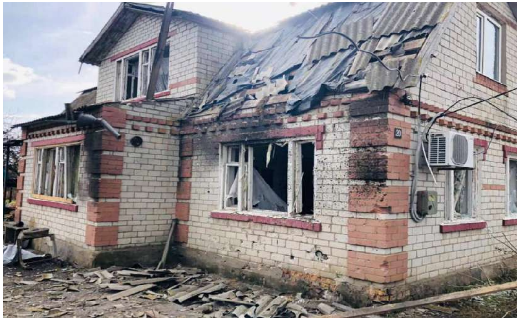
Рисунок 47. Пошкодження приватного будинку, внаслідок обстрілу
